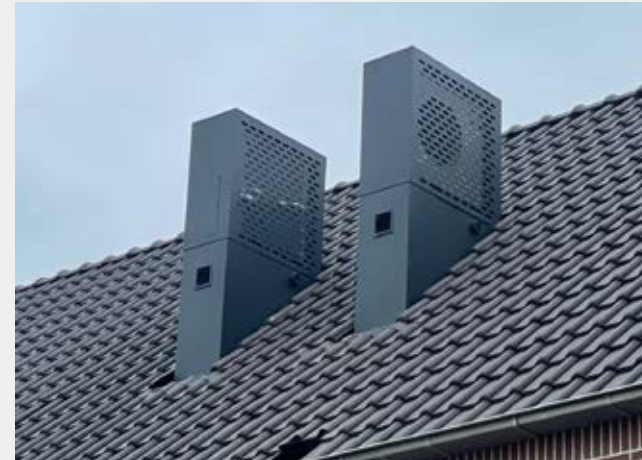
Geïntegreerde warmtepomp als schoorsteen
